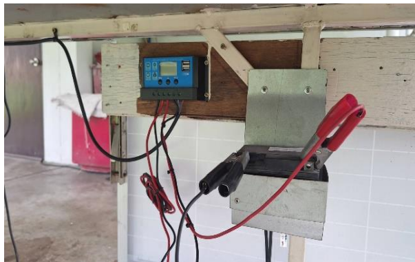
รูปภาพที่ 3.15 ลักษณะการติดตั้งตัวควบคุมการชาร์จและแบตเตอรี่ของระบบ
